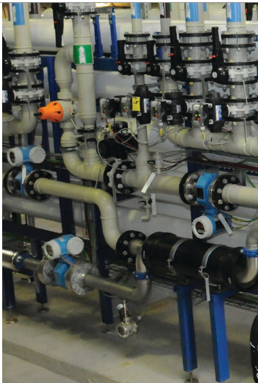
Amagerværket har et avansert vannrenningsanlegg, som avsalter alt vann som brukes på kraftverket. Vannet er sjøvann som kommer direkte fra Øresund. Anleggets måleutstyr er levert av Endress+Hauser.
