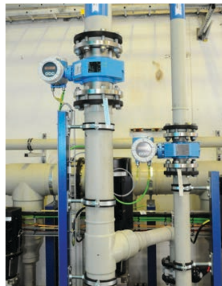
Over hele avsaltingsanlegget på Amagerværket er målere fra Endress+Hauser, som overvåker alle de kritiske parametre for vannkvalitet, inkludert trykk, temperatur, mengde, nivå, pH og ledningsevne.
