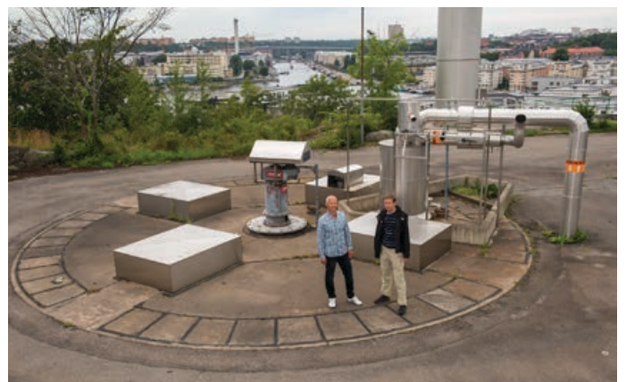
Fra toppen av Henriksdals renseanlegg har man en vakker utsikt over Stockholm. Virksomheten ser man ikke så mye til for mesteparten av anlegget er inne i fjell og inkluderer blant annet syv store råtnetanker som produserer biogass.
