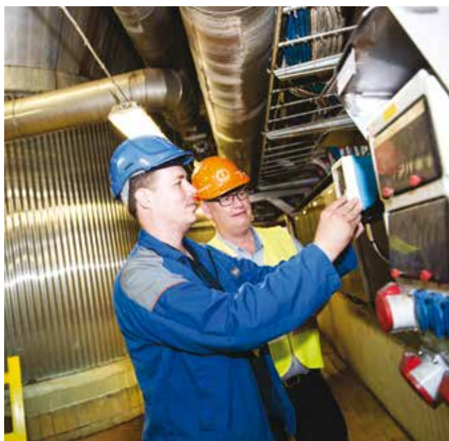
Iggesunds Bruk har et 20-talls måleposisjoner i anlegget, hver måleposisjon er utstyrt med en 2-tråds Liquiline M CM42-transmitter for pH og temperatur.
