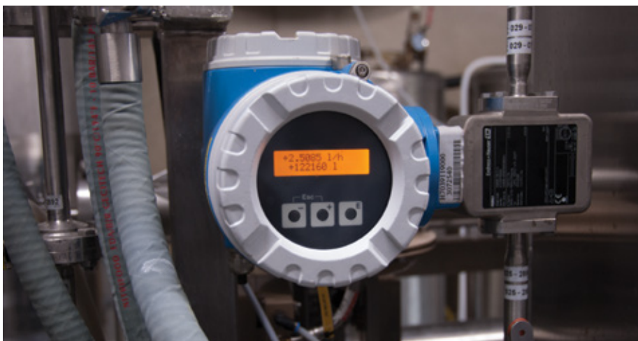
En av de 2 × Promag 50H flowmålere, som er leveret av E+H til filtreringsanlegget i Foulum ved Viborg.
