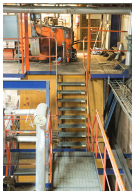
Å ha kontroll på nivået av flis i biosiloen ved varmekraftverket er veldig viktig for prosessen. Micropilot FMR57 radaren er plassert i toppen av siloen.
