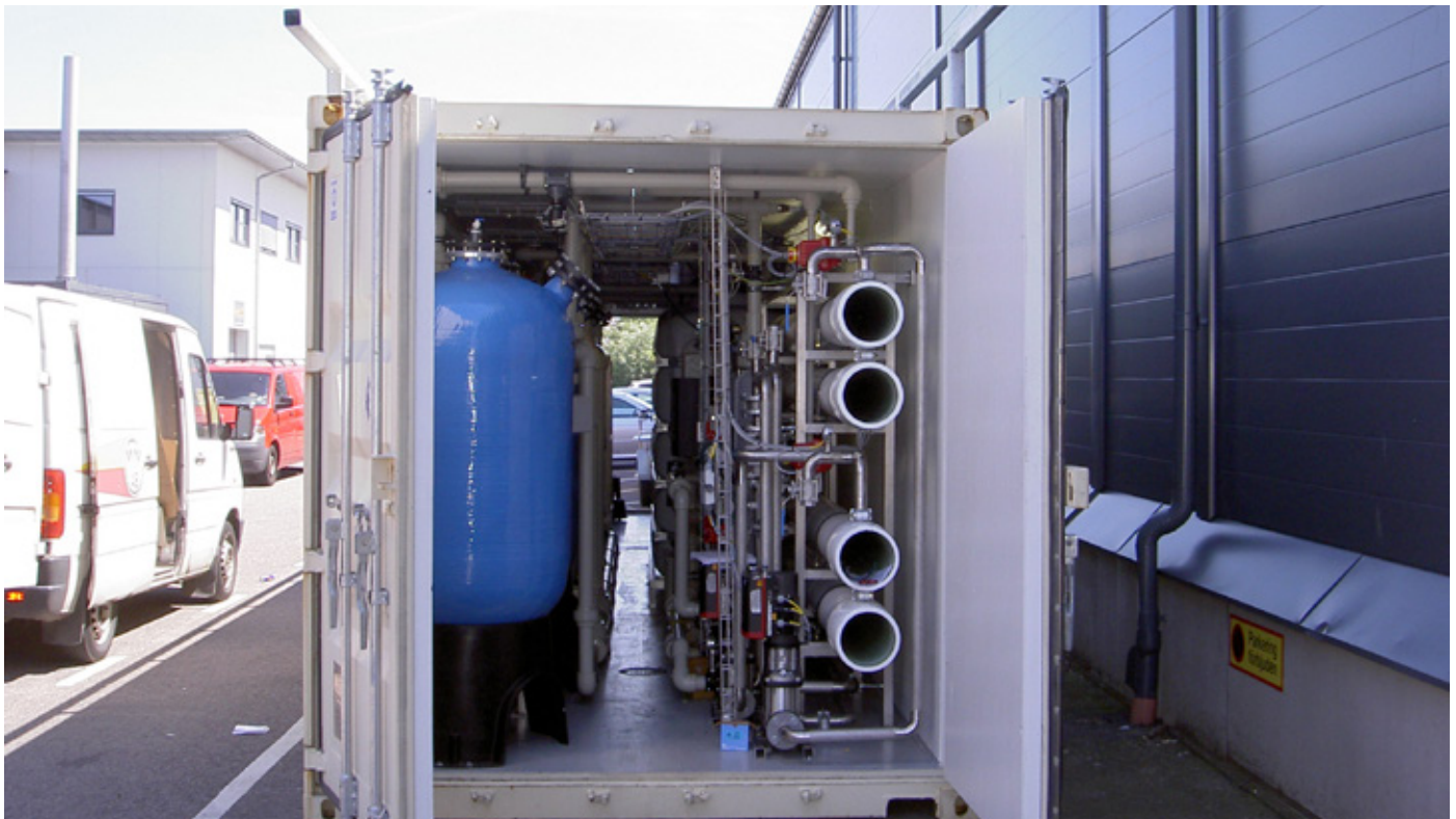
Et komplett ferdig vannverk ble montert i en 40-fots isolert kontainer med luftkondisjonering, designet for å kunne stå ute i sola og tåle varmen i Irak.
