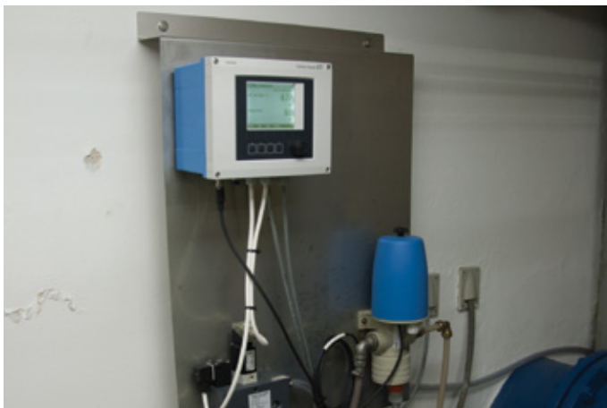
Anlegget slik det ser ut ved innløpet fra brønnene på vannverket i Varde. Her måles pH-verdien og sendes via Liquiline transmitteren til kontrollrommet.
